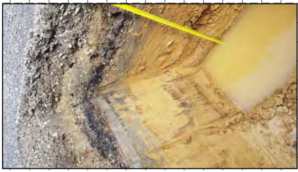
Test pit met target depth at 2 m. Scala Penetrometer met target depth at 2 m.
